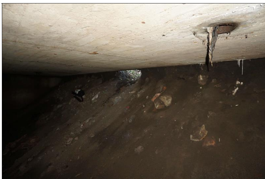
Pohled na levou stranu prostoru pod mostem - úplně zasypáno.
