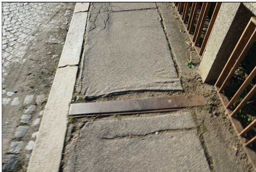
Detail celkového stavu mostu - rozpad povrchu chodníku i vozovky, vegetace ve sparách.
