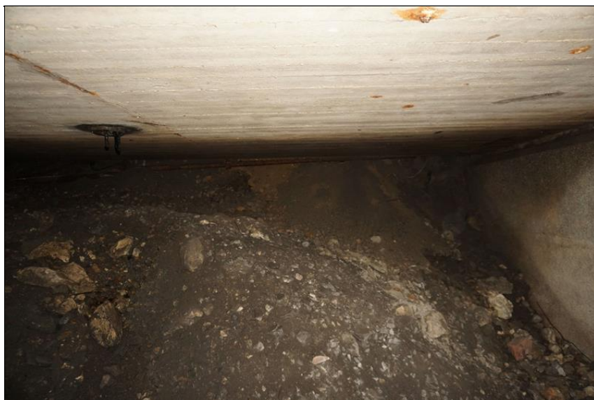
Pohled na pravou stranu prostoru pod mostem - úplně zasypáno.
